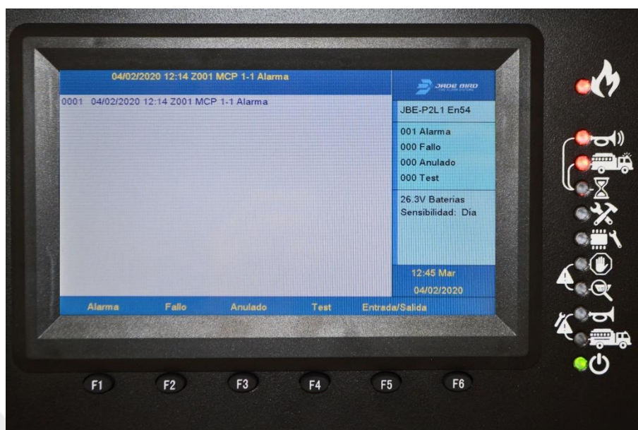
Figura 20: La pantalla de alarma
