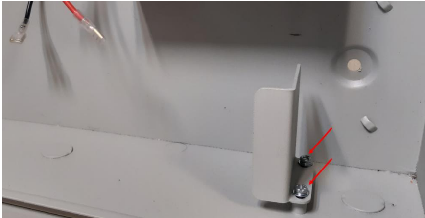
Figura 7: Soportes de soporte de batería
