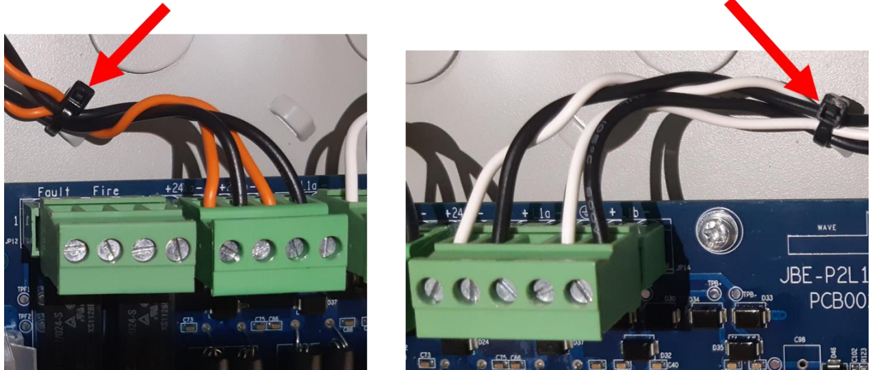
Figura 6: Ilustración de cableado asegurado
